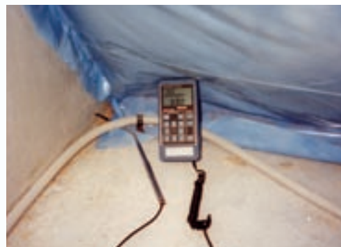
Localisation de fuites avec anémomètre
