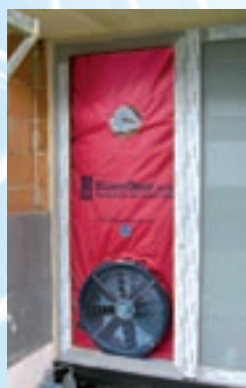
Mesurage BlowerDoor dans le cadre de la réhabilitation d'une maison à colombage
